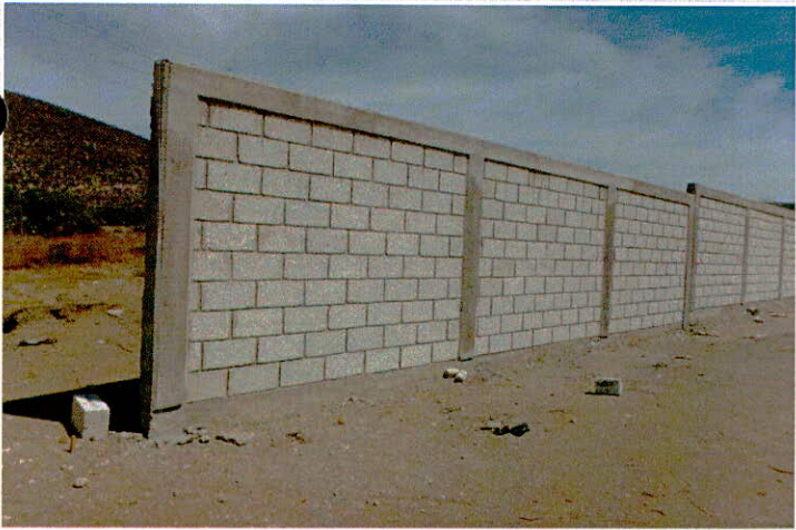
• Dala o cadena de desplante, incluye cimbra y descimbra seccion =15x20 cm, concreto FC=200 kg/cm22-3/4, reforzada con 4 varillas de RN de 3/8 estribos de 1/4 A/C 30 cm
