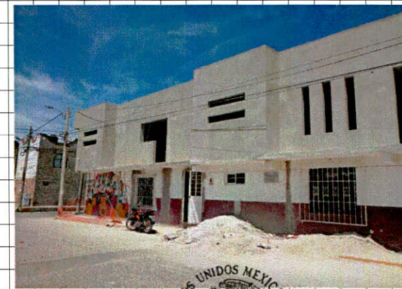
• Suministro y colocación de luminaria para alumbrado público led potencia de 50W.
