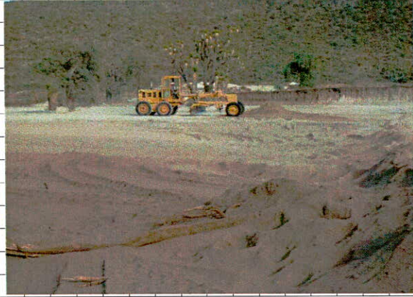
• Mezclado, tendido y compactación de la capa subrasante formada con material seleccionado
