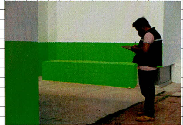
• Suministro y aplicación de pintura vinilica comex 100 sobre muros y plafones de yeso
