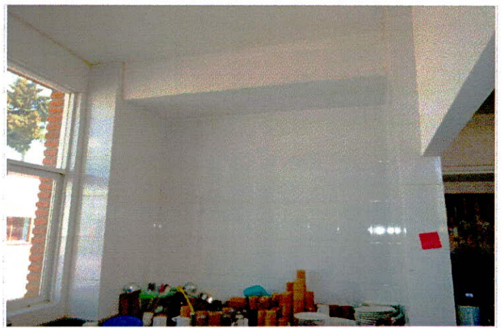
• Suministro y colocación de azulejo blanco de primera asentado con mortero Cem-are 1:5
