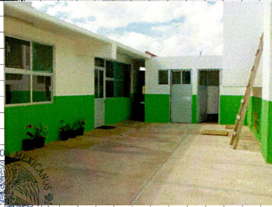
• Suministro y aplicación de pintura vinilica comex 100 sobre muros y plafones de yeso
